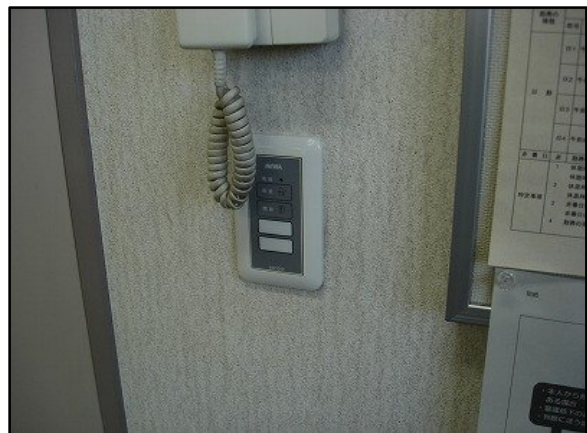
操作表示器取替後
