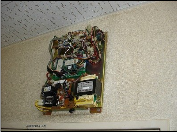
電気錠制御盤 交換前
